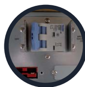
Breaker de baterías
